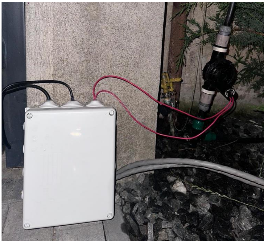
Figura 23-Amplasarea controllerului pe teren
